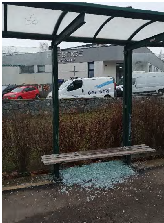
Posledica vandalizma - poškodovano avtobusno postajališče na Patizanski ulici
